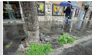
Marciapiede rotto in via Ferrari, a Prati (foto Giuliano Bervegny)
